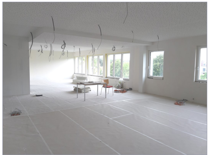
Aktueller Fortschritt: Nach den Trockenbau- und Installationsarbeiten haben bereits die Malerarbeiten begonnen.
